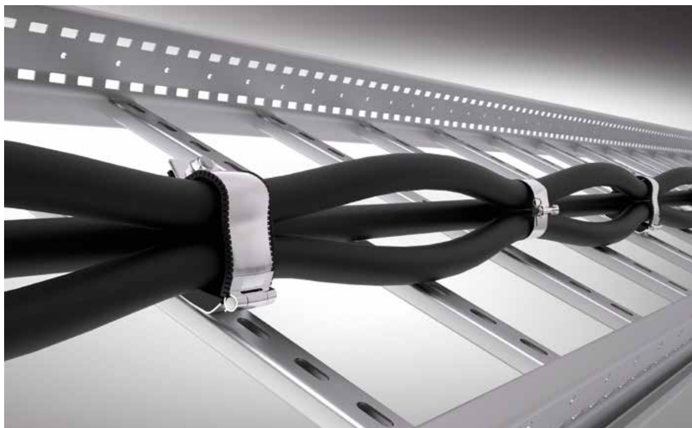
电缆在发生短路后出现“圆拱结构”
