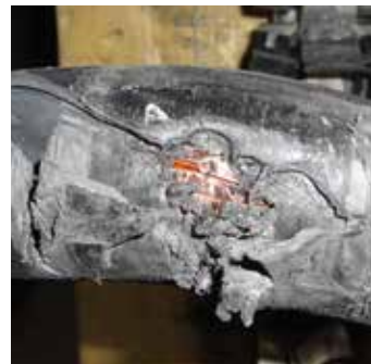
螺纹接触造成的重大电缆损伤
